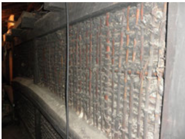
写真4 古い土塗り壁
